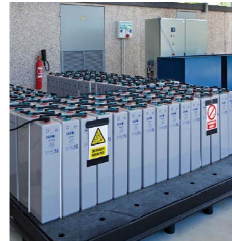
▲ Baterías de plomo. PB batteries.
