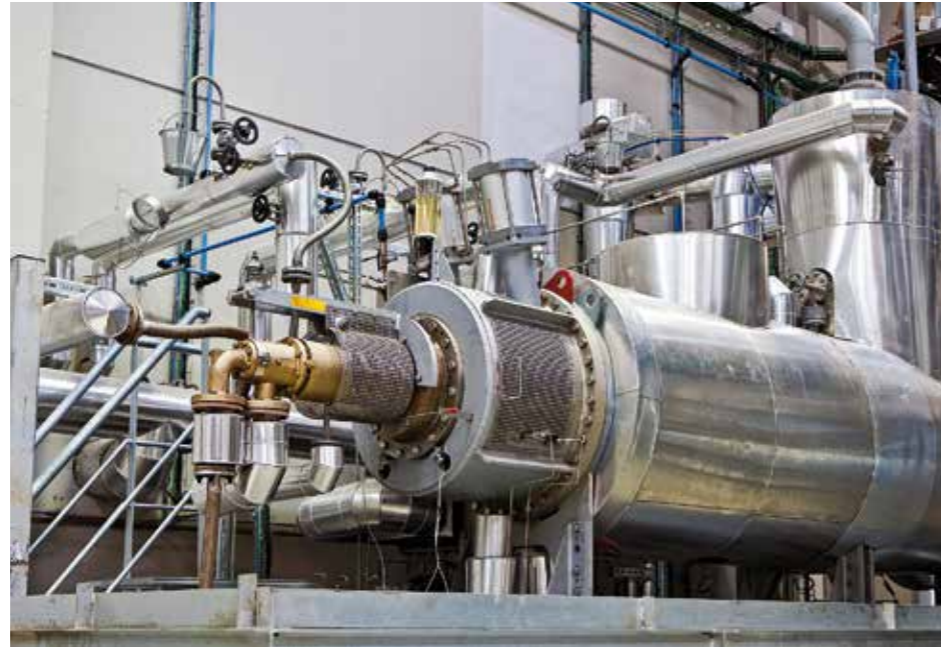
▲ Reactor de torrefacción-CB2G. Torrefaction reactor-CB2G.
