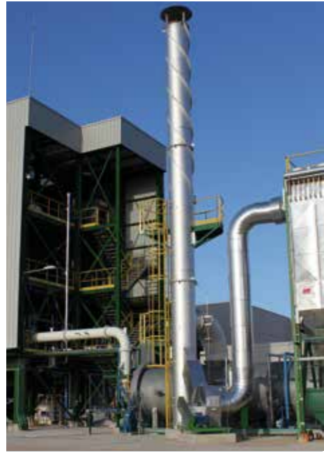
▲ Isla de gasificación-CB2G. Gasification island-CB2G.
